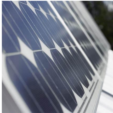
Detall d'un panell solar
